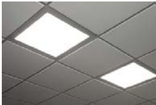
Fig. 4.1.4 Gypsum False Ceiling
